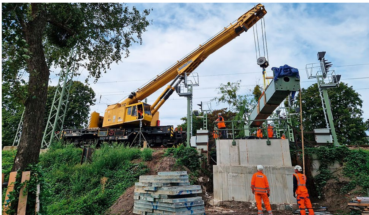
Abbildung 7 Aufbau einer Signalbrücke Foto: Ute Göldner
